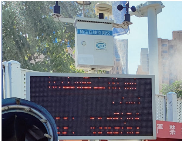
扬尘及噪音监控设备
